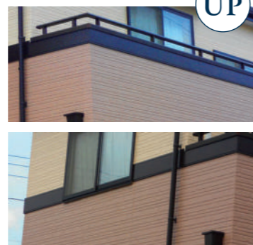
窓枠やベランダの取っ手などの 雨の跡が付きやすい部分が汚れていません。
